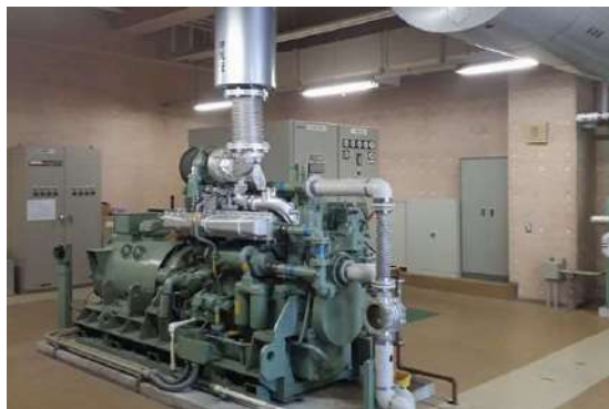
非常用自家発電設備
